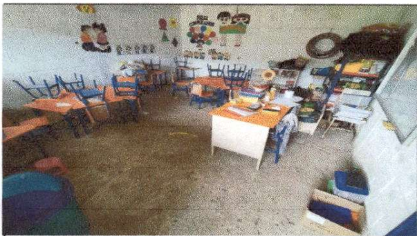
FOTO 3: Sustrución de piso cerámico
